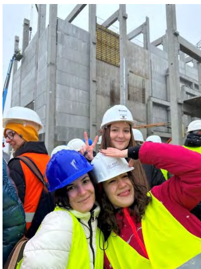
Figura 5.117 - Vizita studenților pe șantierul viitoarei unități de producție și ambalare pentru produse farmaceutice - STADA M&D România, Parcul industrial Arieș, Turda – studenți anul III, CCIA, IMC, 2023
