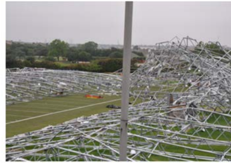
Fig. 2.2. Structură metalică spațială prăbușită sub acțiunea vântului [6]
